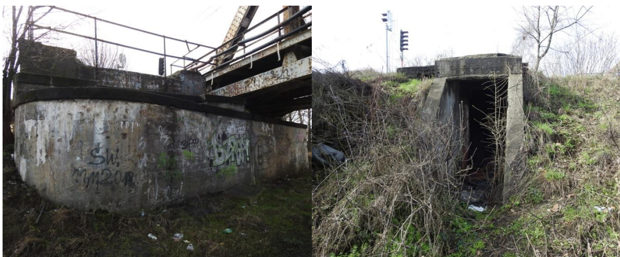
Fot. 12 i Fot. 13 Przyczółek na wschodnim brzegu rzeki oraz wejście do obiektu po byłym schronie
