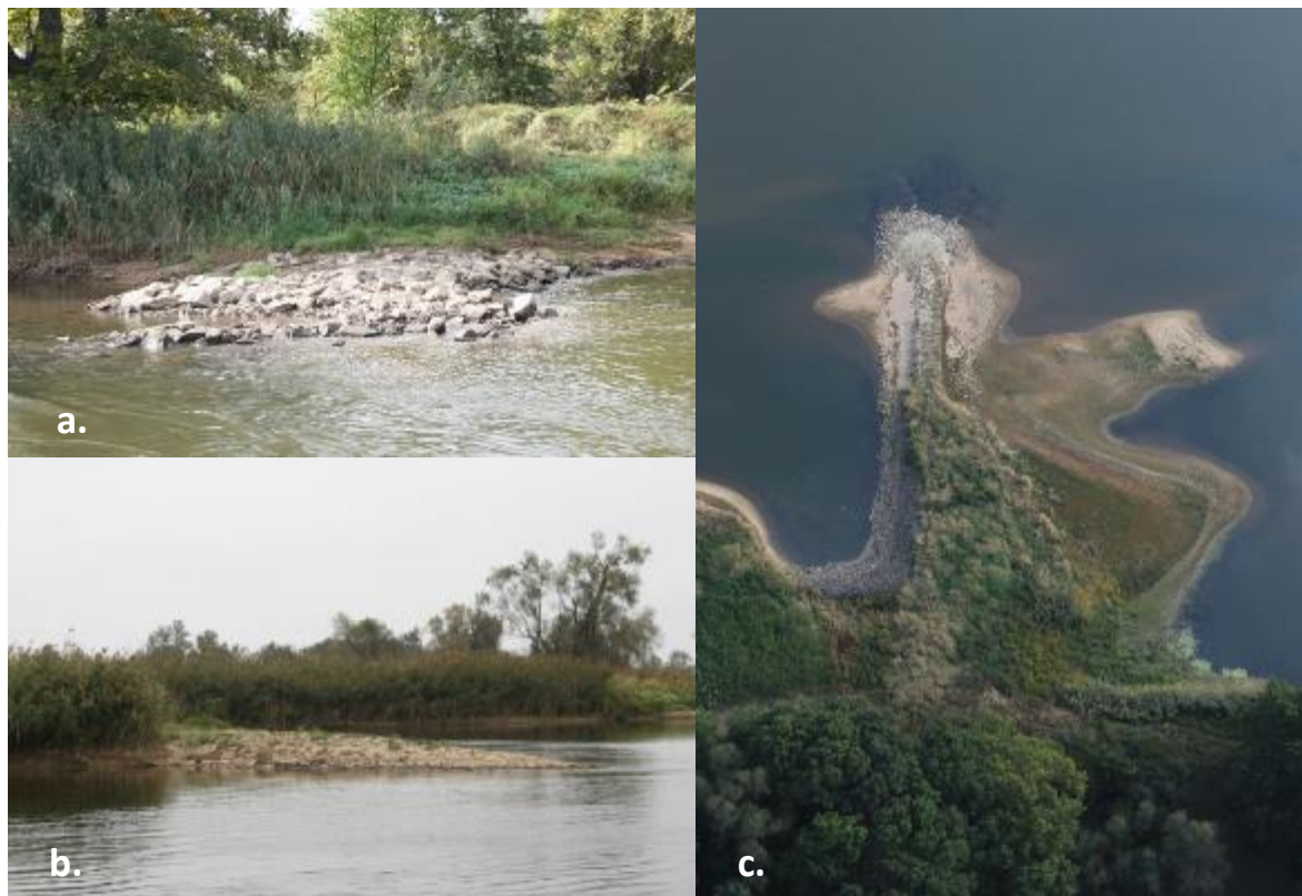
Rys. 2: Ostrogi na Odrze granicznej a. uszkodzona ostroga (615-09); b.) ostroga w dobrym stanie (610-15) i c.) zdjęcie lotnicze ostrogi w dobrym stanie koło m. Ratzdorf (zdjęcia: WSA Oder-Havel).
