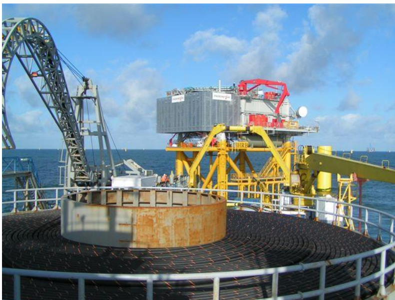
Rysunek 4-2 Montaż kabli ze statku do układania kabli w Anholt (Fot.: Ramboll).
