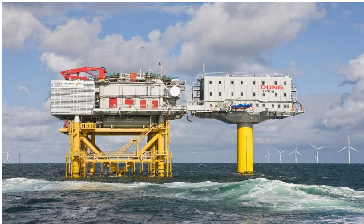
Rysunek 3-8 Przykładowa platforma mieszkalna (po prawej) na morskiej farmie wiatrowej Horns Rev 2, ze stacją elektroenergetyczną zlokalizowaną w pobliżu (po lewej). Platforma mieszkalna jest posadowiona na fundamencie jednopalowym, natomiast stacja posiada fundament kratownicowy.
